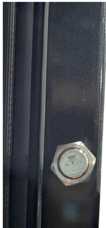
Installation du capteur
